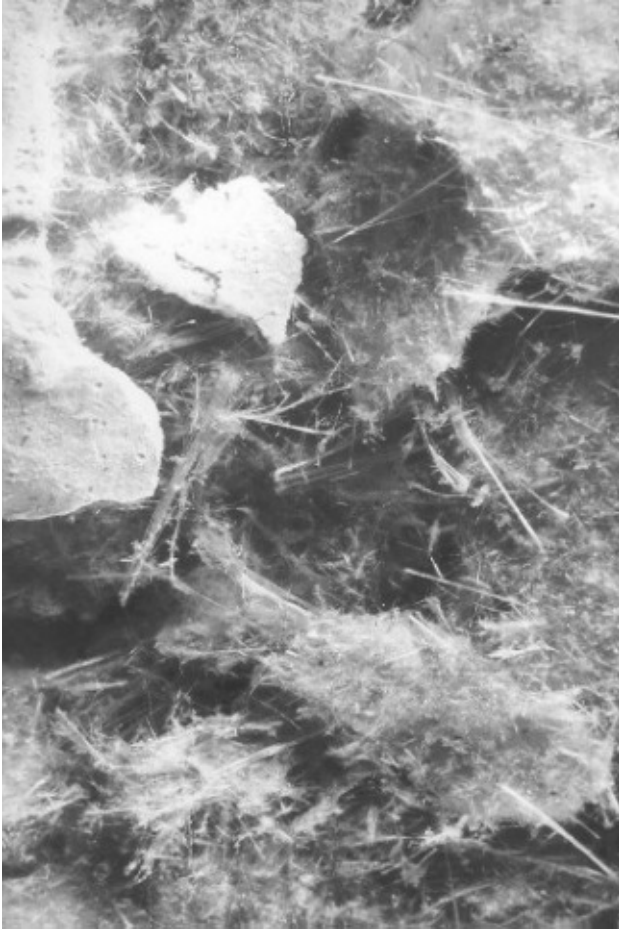
Flocage composé de laine minérale et de fibres d'amiante, longues et pointues, photo SA
